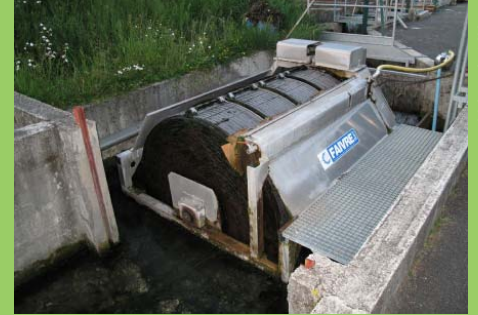
Filtre à tambour servant à récupérer les matières en suspension en aval de la pisciculture
