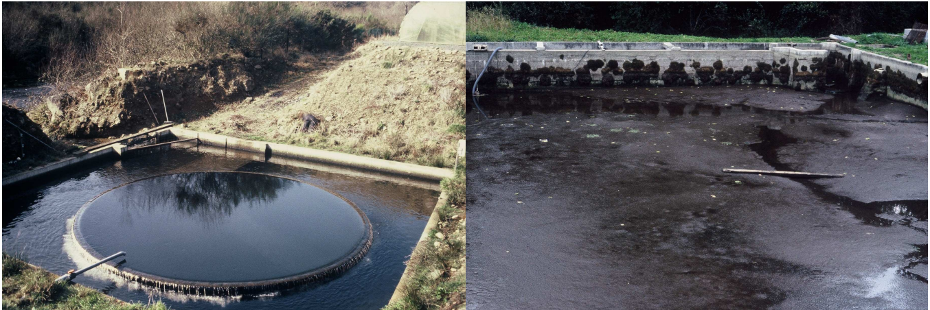
Décanteurs : circulaire et à plat – Photos : Rémi Bertran
